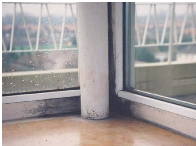
Bild 3 Tauwasserbildung im Bereich einer Fenster- außenecke
