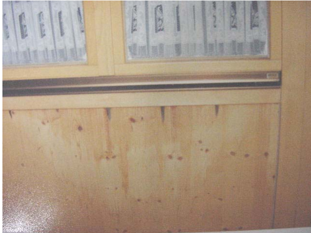
Bild 4 Feuchteschäden durch Tauwasserbildung in der Ausfachung
