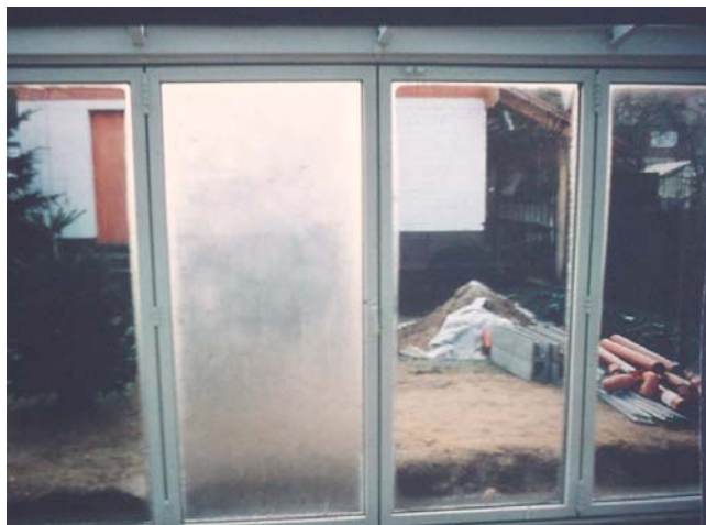
Bild 2 Tauwasserbildung auf Mehrscheiben-Isolierglas mit unterschiedlichen Wärmedämmeigenschaften
